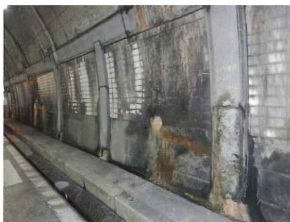
トンネル覆工の劣化状況
