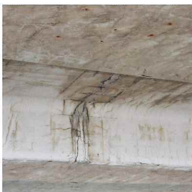
橋梁の橋げたの劣化状況(手取川橋)
